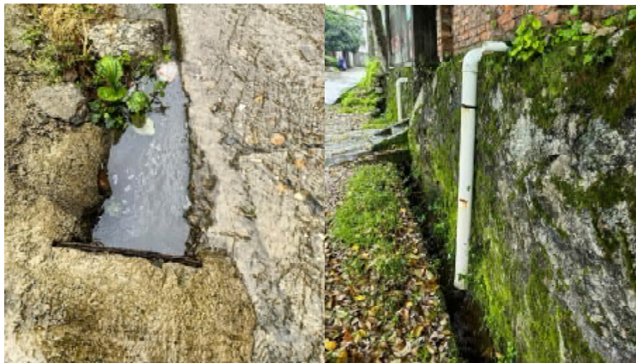
图 5-3 周边道路雨水溢出、雨污合流至水沟
