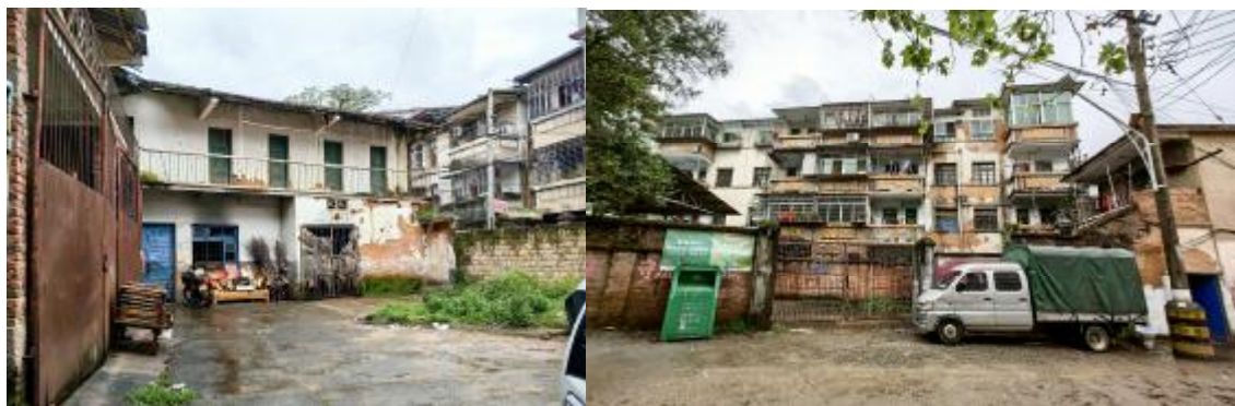
图 5-1 环卫站现状外墙破损严重
