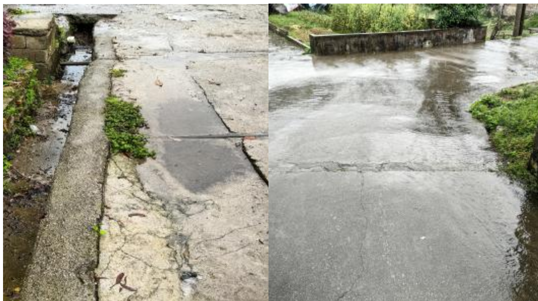
图 5-4 路面塌陷、积水
