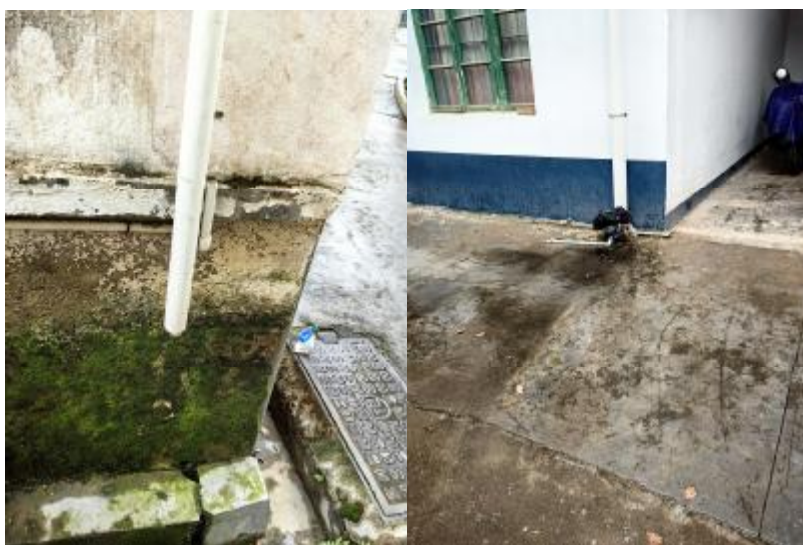
图 3-1 医院宿舍、六中集资楼雨落管设施不完整
