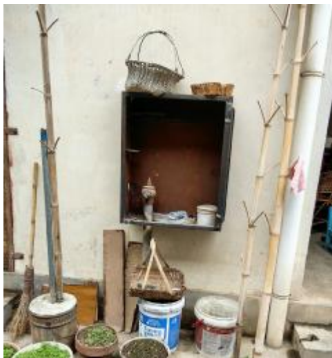
图 3-6 医院宿舍内消火栓设施缺失
